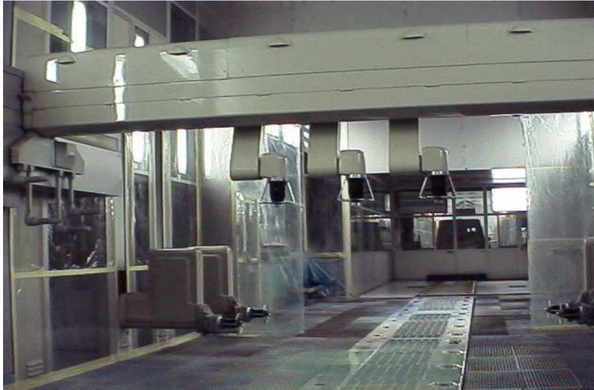
Nivel 5 Máquina de techo
